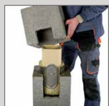
13. Пустотілий блок з вирізаним отвором на коліно димових газів поставити на розчині.
