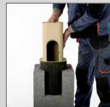
9. Встановити ревізю в місце відведення конденсату, усунути надмір замазки з внутрішнього боку труби.
