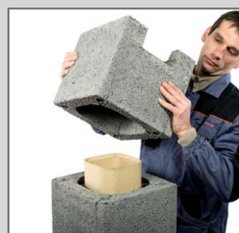
20. Пустотілий блок з вирізаним отвором на під'єднання димовідних газів встановити на розчині.
